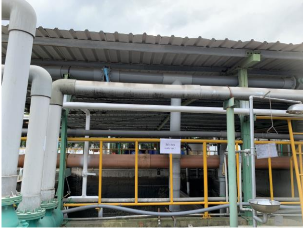
Bể chứa nước số 1
