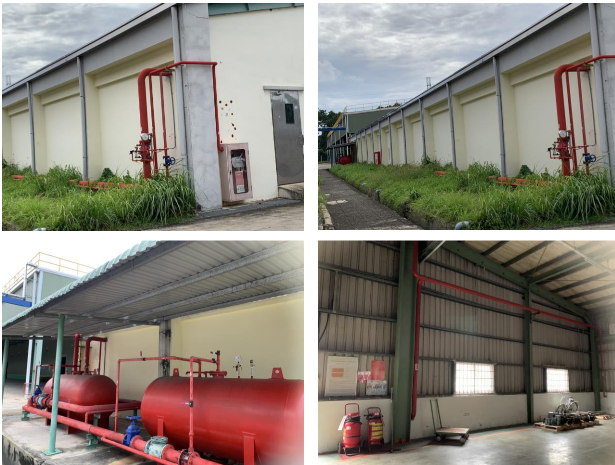
Hình 3. 22. Hình ảnh công trình, thiết bị ứng phó sự cố cháy nổ
