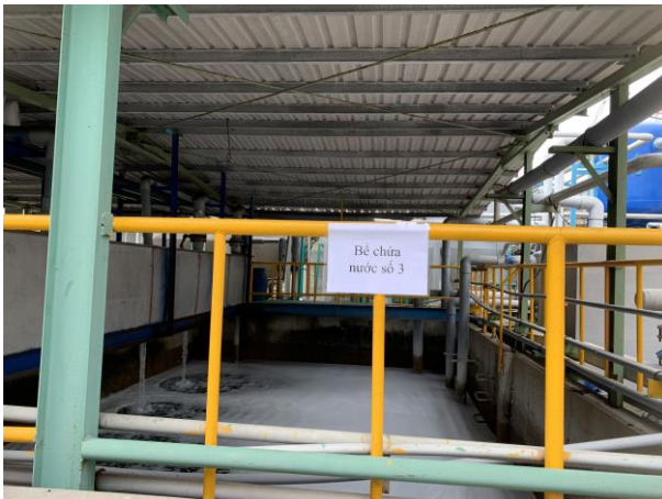
Bể chứa nước số 3
