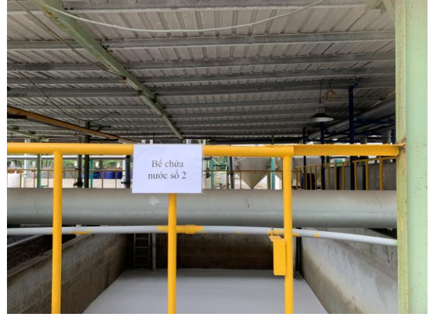
Bể chứa nước số 2
