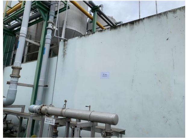
BỂ chứa nước số 3
