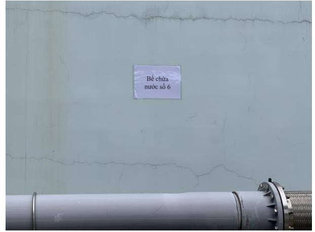
Bể chứa nước số 6
