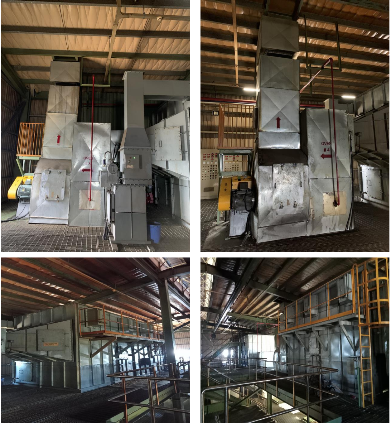
Hình 3. 18. Hệ thống xử lý hơi hoá chất từ quá trình sấy tại xưởng vải màn
