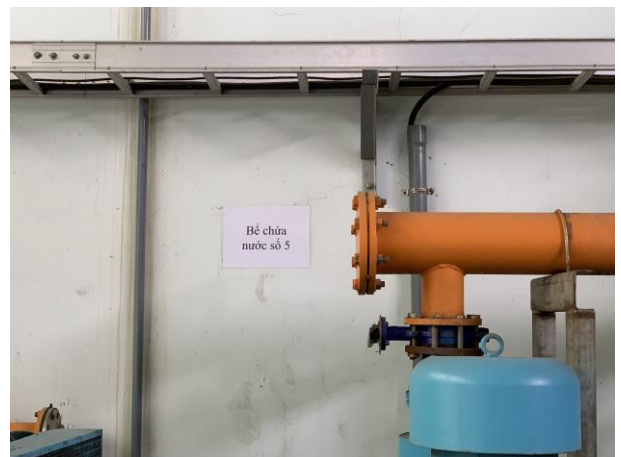
BỂ chứa nước số 5
