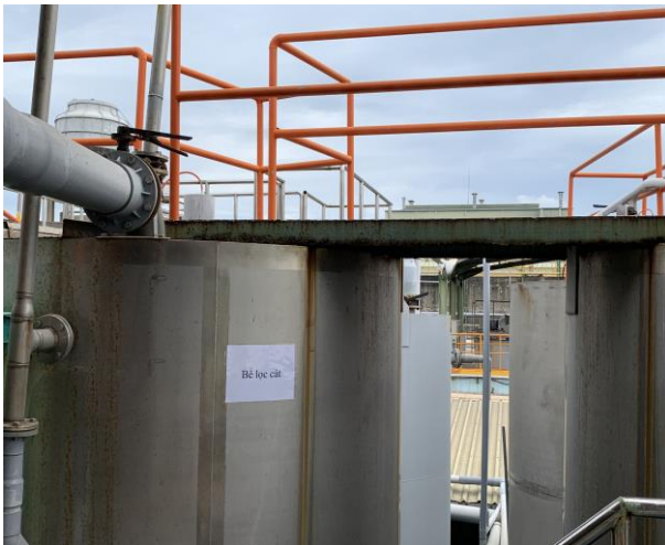
Bể lọc cát
