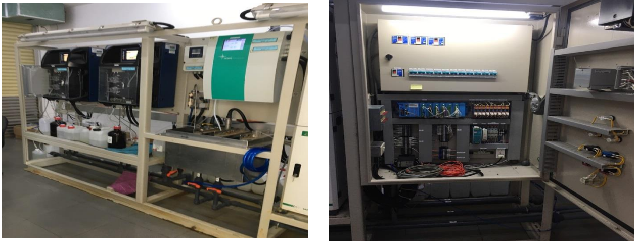
Trạm quan trắc tự động của dự án
