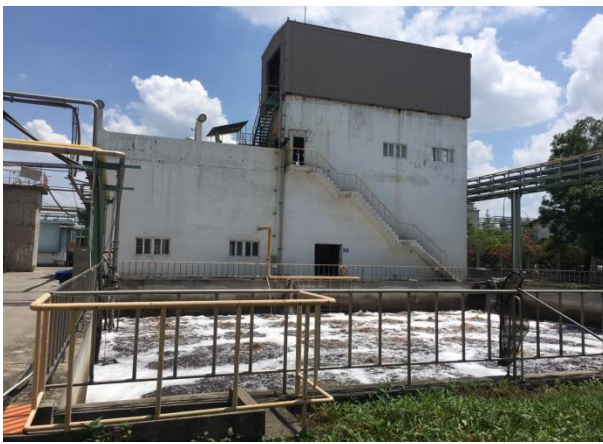
Bể điều hoà
