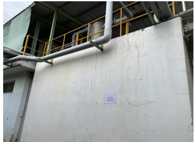
Bể chứa nước số 4
