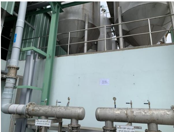
BỂ chứa nước số 4
